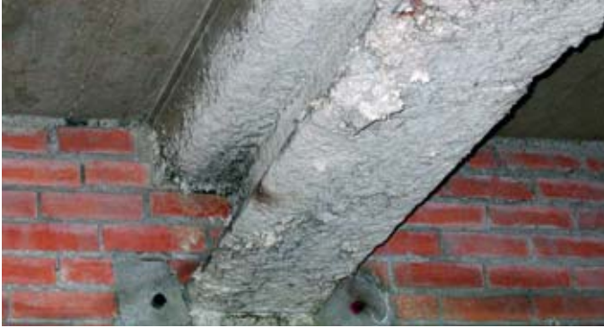
Spritzasbest an Stahlträger
