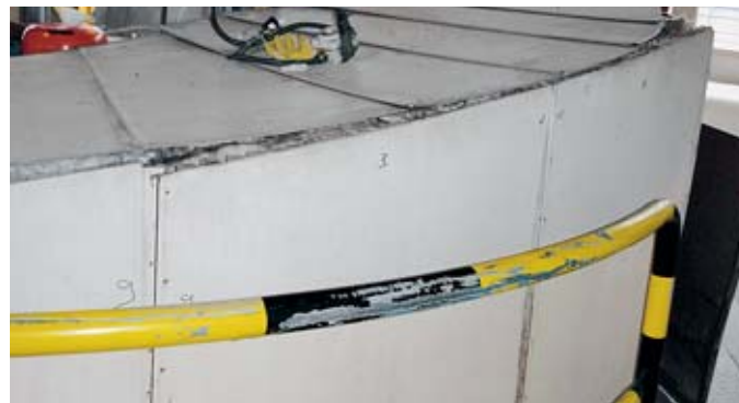
asbesthaltige Dämmung hinter einer Verkleidung
