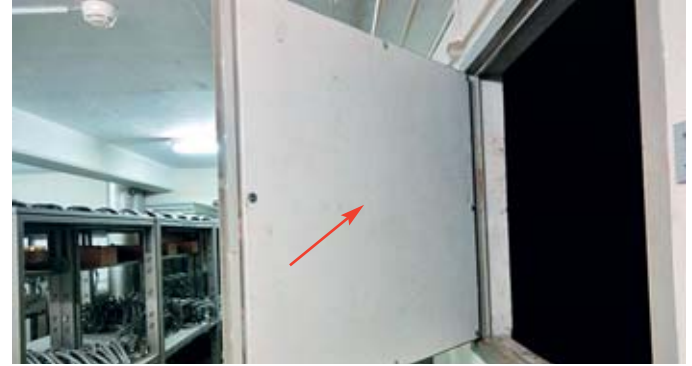
Brandschutz an Türe
