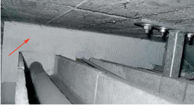
Kabeldurchbruch mit Brandabschottung
