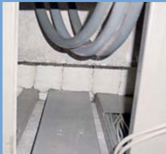
Brandabschottung mit Asbestkissen
