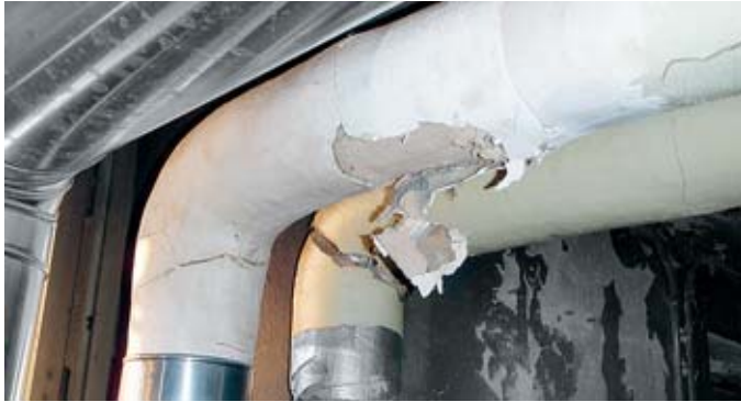
Rohrleitung mit asbesthaltigem Mörtel
